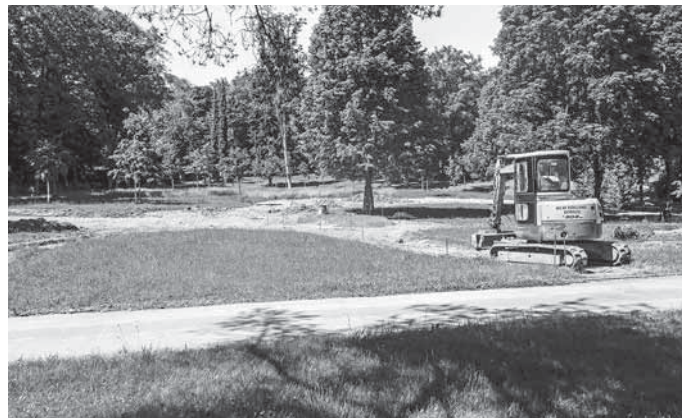
Im Waldfriedhof Backnang haben die Bauarbeiten für einen Urnenpark begonnen. Foto: Stadt Backnang
